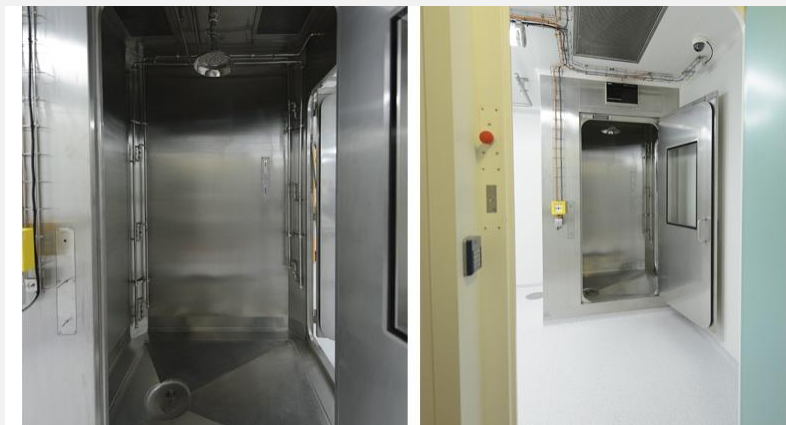
Douche de décontamination
